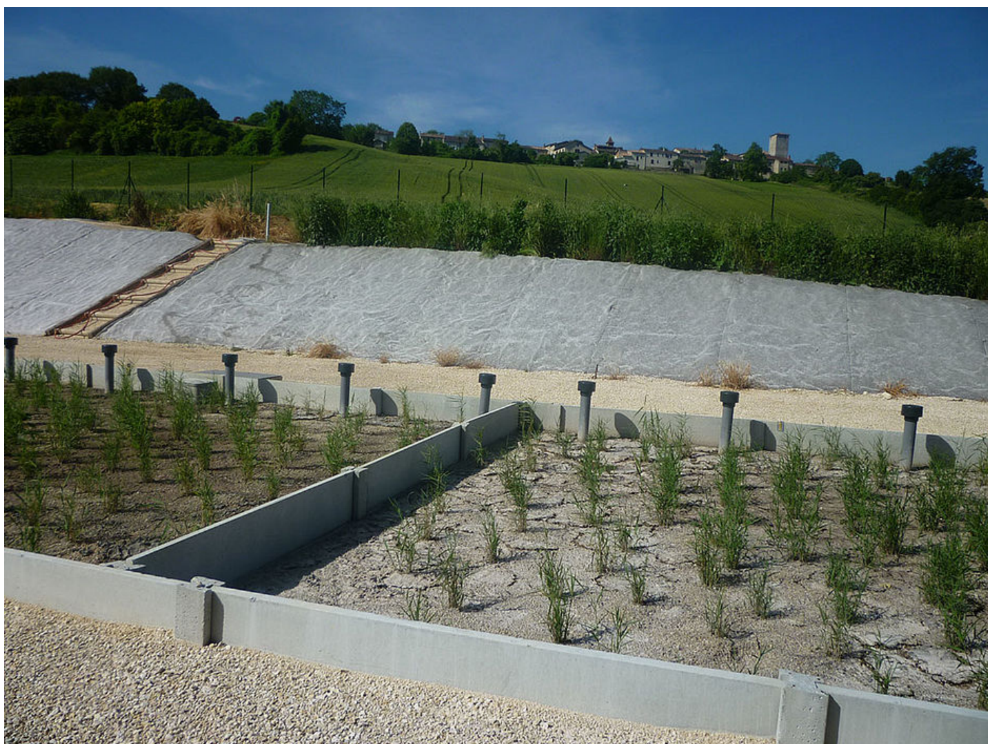
Station d'épuration de Plieux – Crédit photo : Département du Gers
